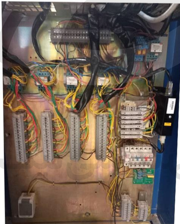
تصویر ۱۴-۱ سینی برق کنترلر رله ای
